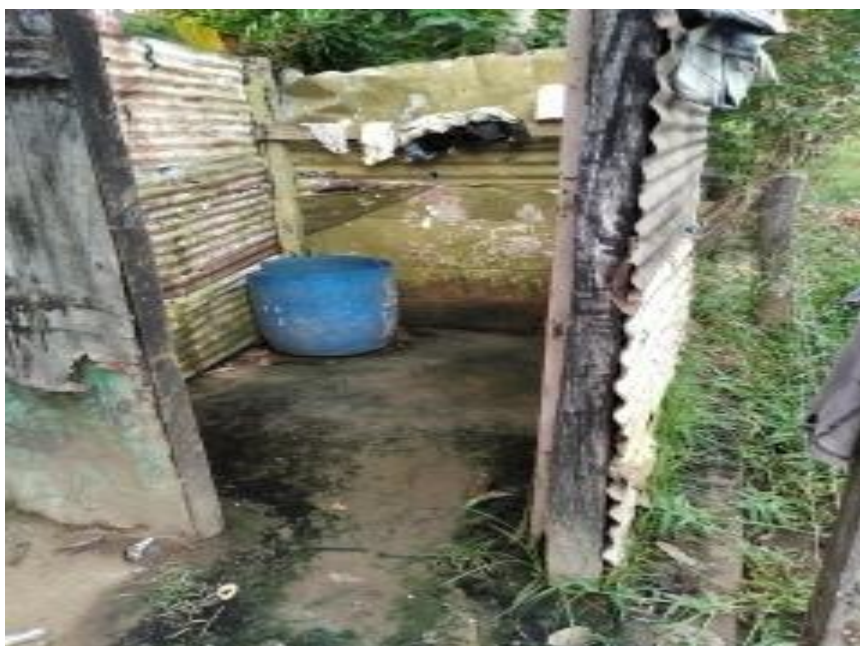
Baño en la zona Panamericana, en condición precaria. Foto Carlos Espinosa. Marzo, 2020.
