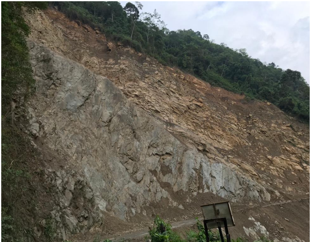
Deslizamiento La Roca vía Zea Panamericana, extremadamente activo, es un riesgo permanente sin control ni obra ambiental para seguridad del tránsito de vehículos y peatones. Foto Geog. Jovito Valbuena. 2022.
